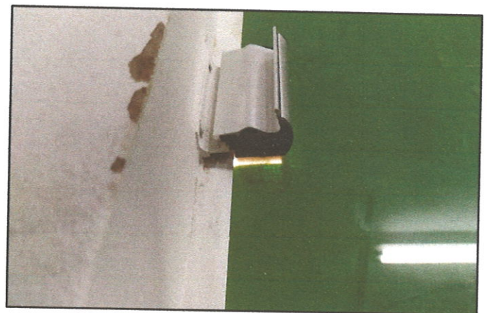
FIGURA 06 - Fechaduras das janelas danificadas
