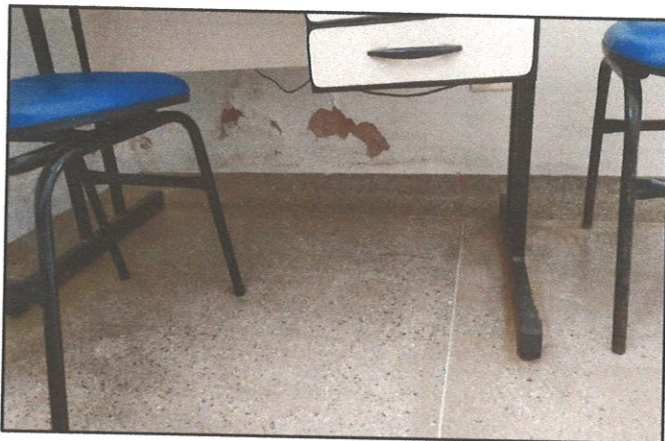
FIGURA 05 - Parede com trincas e manchas
